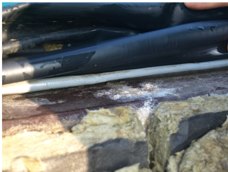
Abbildung 8: Undichter Behälterrand mit Schwefelablagerungen (Kohne 2010)
