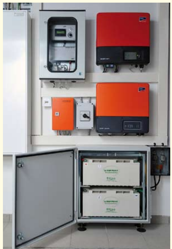
Wechselrichter mit Speicher
