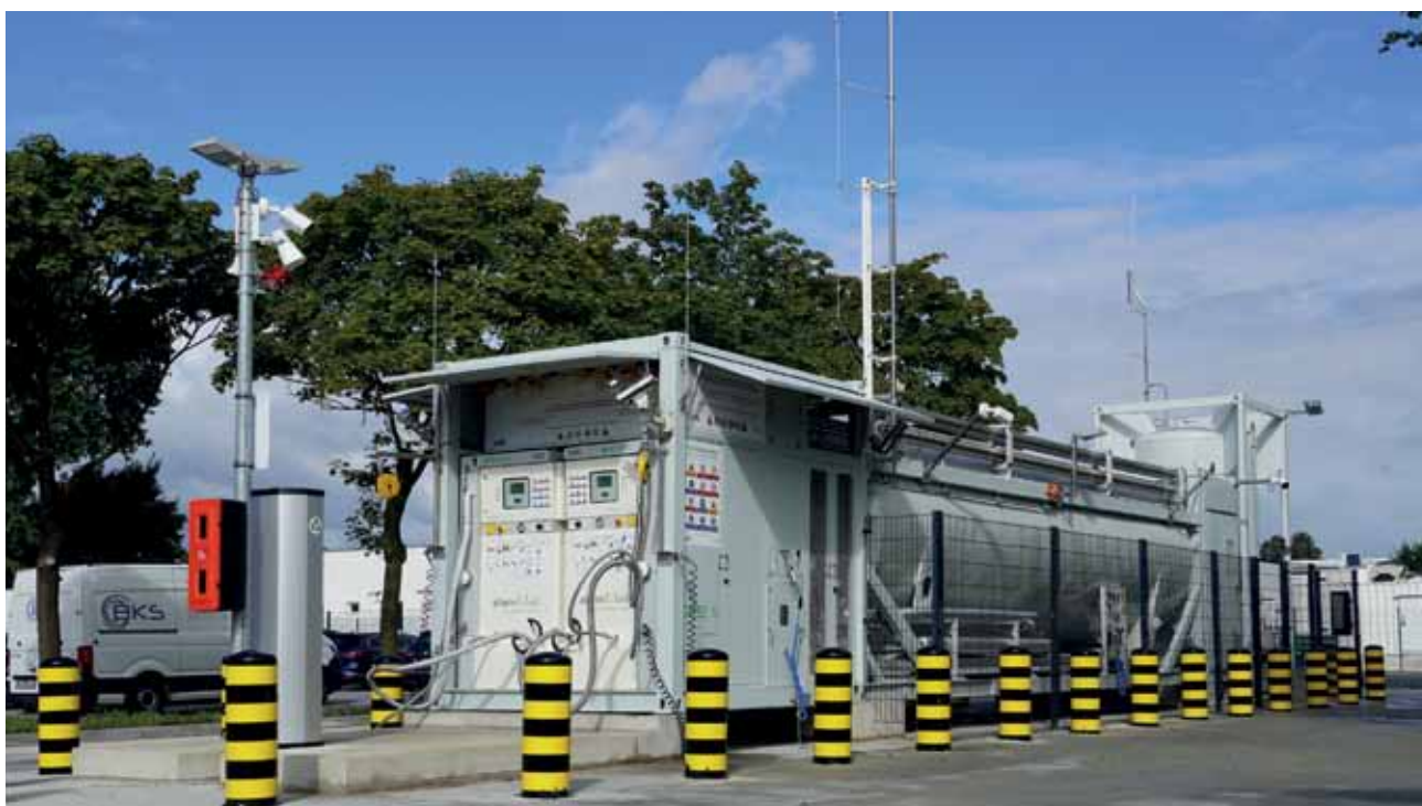
LNG & REEFUEL-Tankstelle der Alternoil GmbH in Oldenburg
