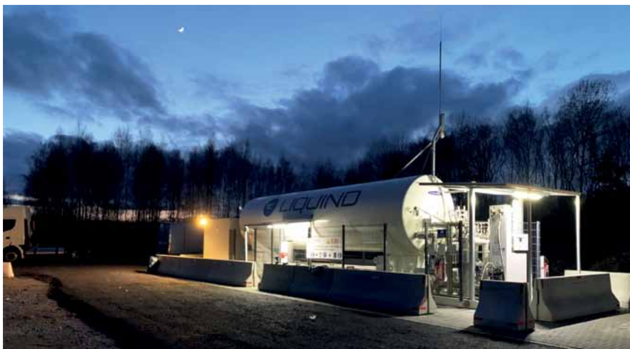
LNG-Tankstelle der LIQUIND 24/7 GmbH in Göttingen
