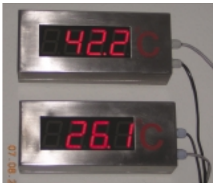
Temperaturanzeigen im Dachbereich im Sommer
